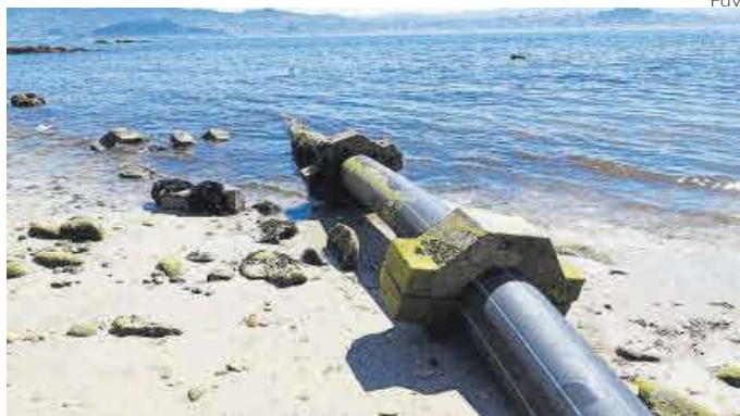
Tubería del aliviadero del saneamiento en la playa de Tirán.
