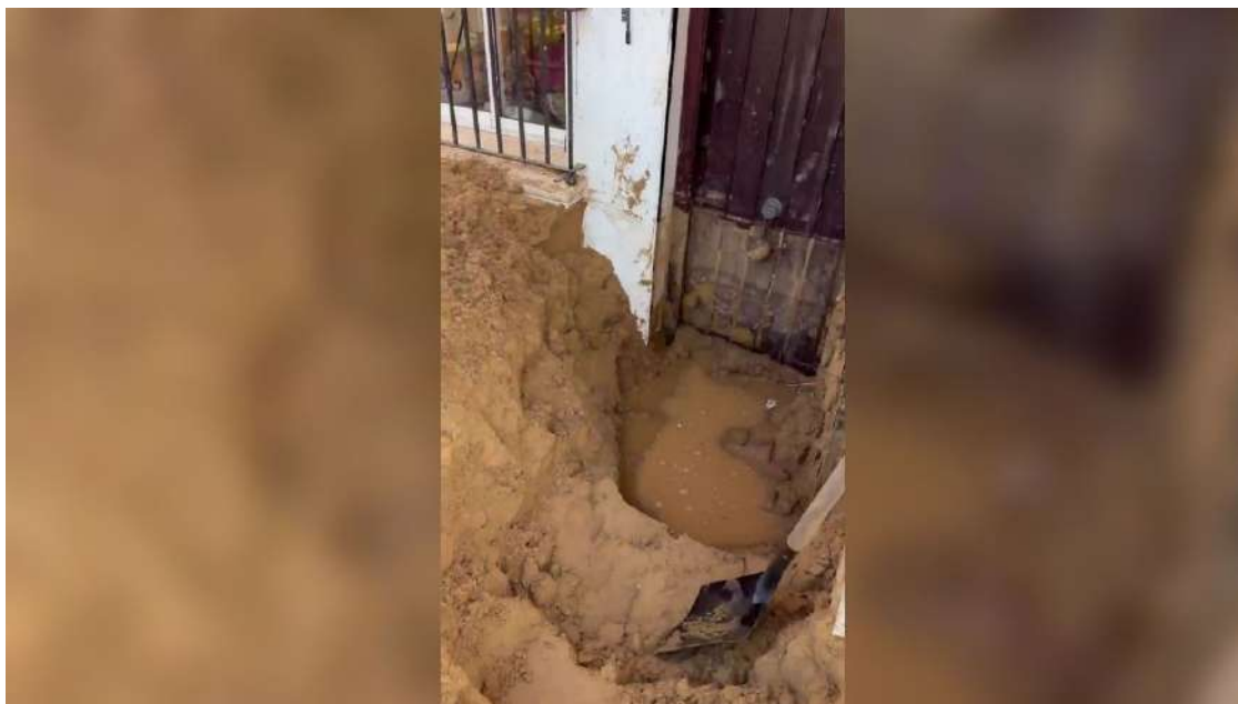
Tres viviendas, sepultadas bajo barro por la rotura de una tubería de agua en Matalascañas
